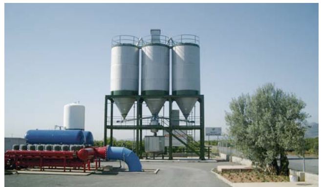
Estacion de abonado y filtros (Villarreal sectores II, IV y V). /SEIASA
