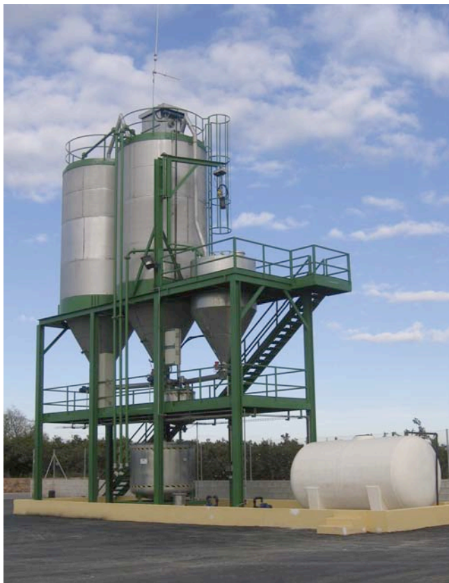
Estación abonado sólido (Villarreal sector III). / SEIASA
