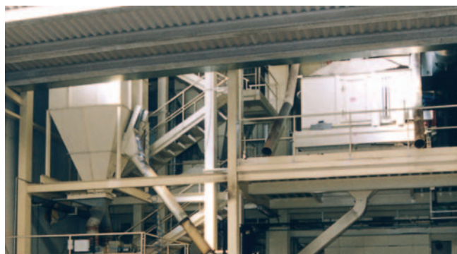
Instalaciones de la Planta de Purines de Vall d'Alba
